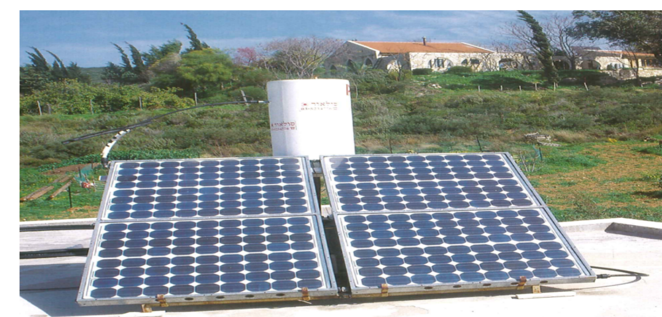
Fig. 6 - Chauffe-eau solaire : l'énergie fournie par les panneaux photovoltaïques permet de chauffer l'eau dans le collecteur.
