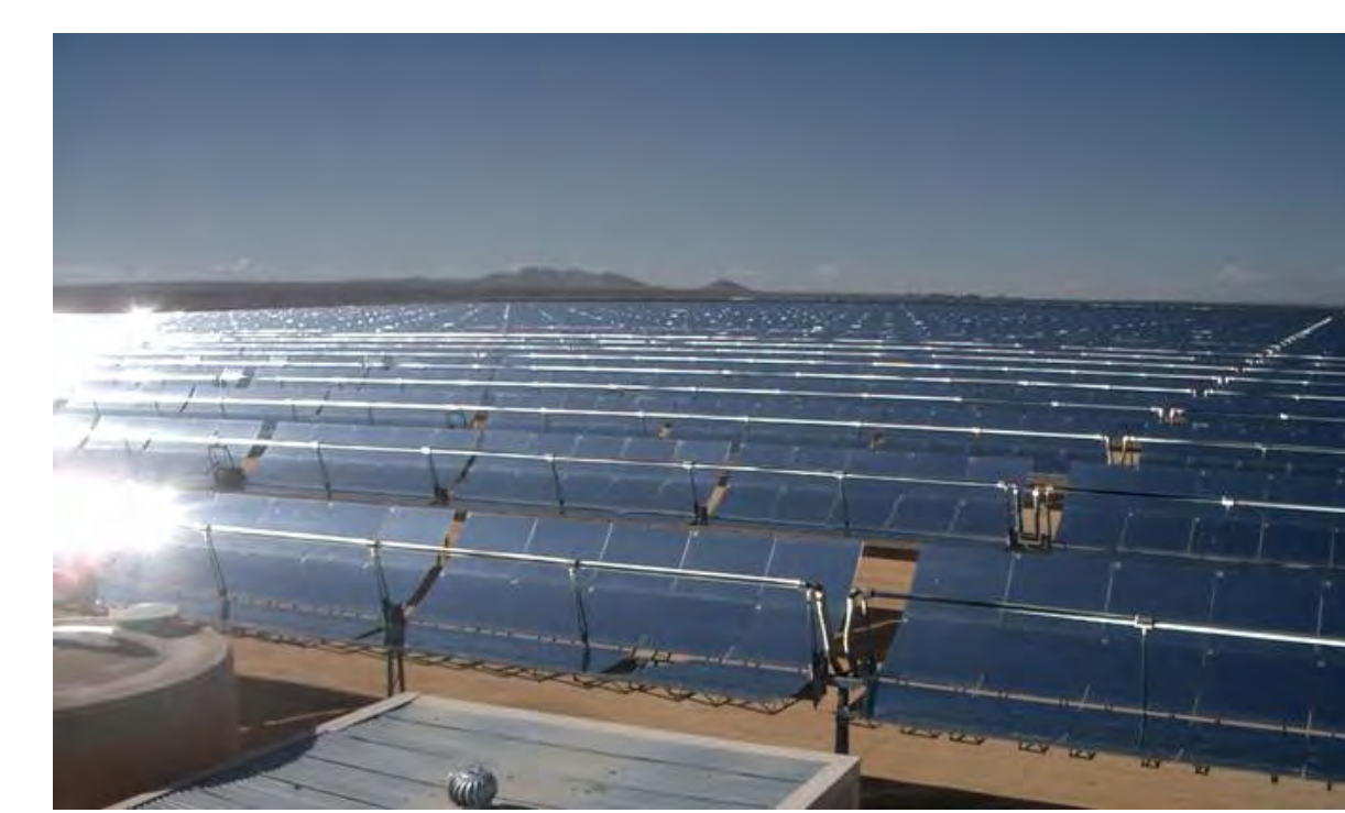
Centrale solaire à capteur cylindro paraboliques de Kramer Junction Californie
