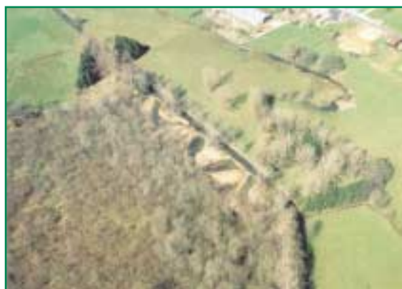
Vue aérienne du chantier de réhabilitation de la haute Semois. Pour différentes raisons de propriété et de niveau topographique (la Semois a été abaissée de 1 à 2m), il était difficile d'envisager le retour de la Semois dans son ancien cours.
